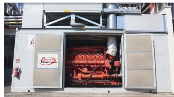
Motore e impianto da 1 MW presso un cliente a Vicenza
